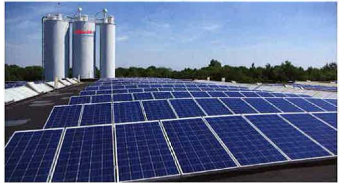
Die Module bedecken das Dach des Firmengebäudes.
